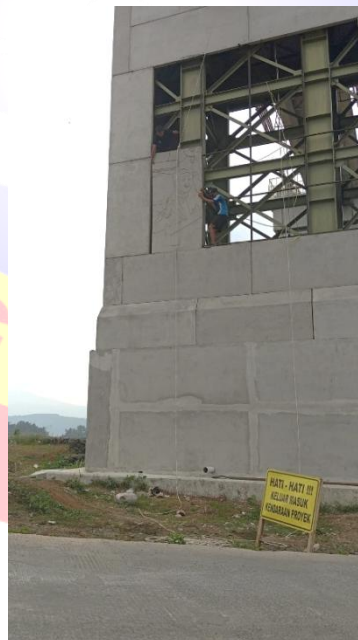
Gambar 1.1 Dokumentasi Tenaga Kerja Konstruksi Tanpa APD Pada Pekerjaan Pembangunan Jembatan Panenjoan Jatigede Sumedang
