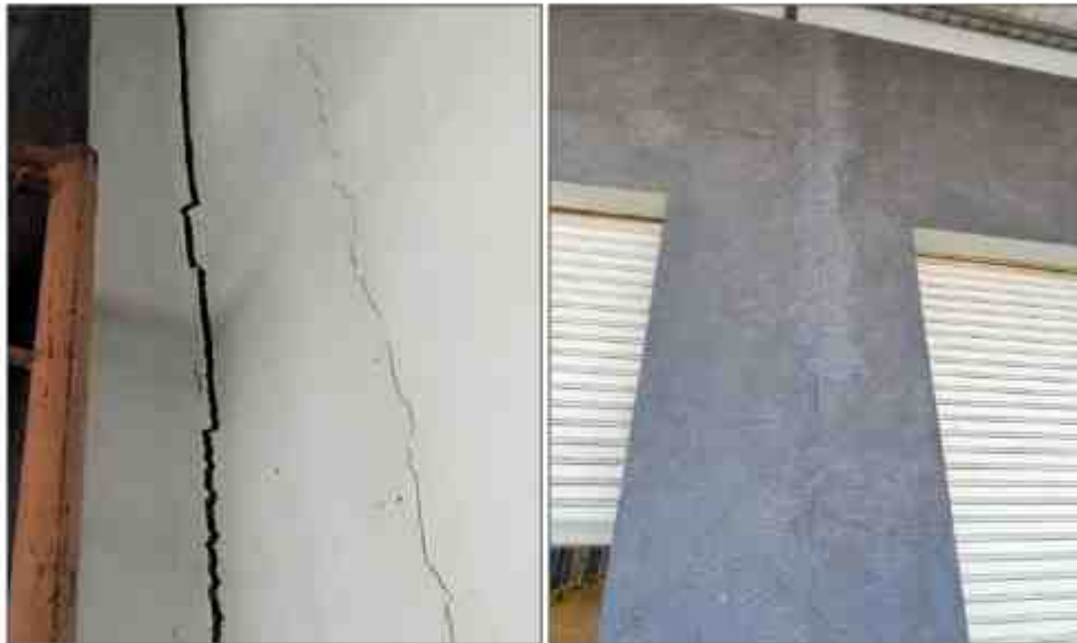
Gambar 4.5 Keretakan Dinding Bangunan
