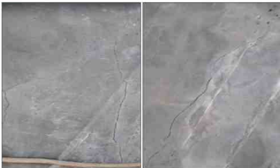
Gambar 4.6 Keretakan Struktur Lantai
