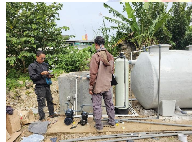
Setting Multimedia Filter Sistem dan Perpompaan
