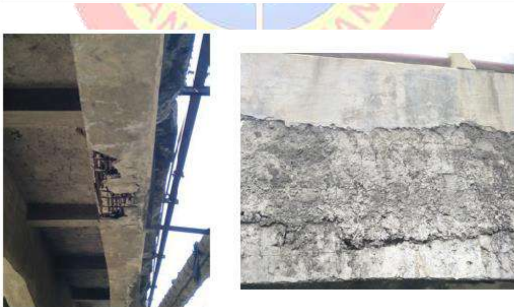
Gambar 2.22 Ilustrasi Kode Kerusakan 201 Cacat pada Beton termasuk Beton Rontok/Spalling, Kropos, Berongga, dan Kualitas Beton yang Rendah (Wisconsin DOT, 2020)
