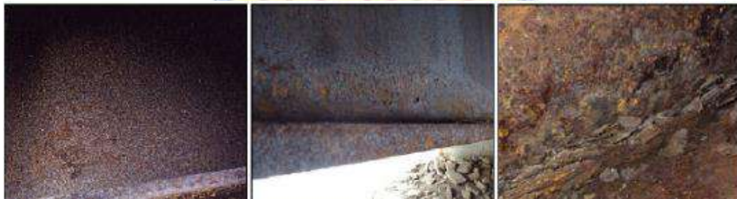
Gambar 2.28 Ilustrasi Kode Kerusakan 301 Penurunan Mutu atau Kinerja Proteksi Korosi (Lapisan Pelindung/Cat), dari Kiri ke Kanan Kerusakan Berupa Degradasi Film Oksida dan Tekstur Bertambah Parah atau Volume Semakin Meluas (Wisconsin DOT, 2020)
