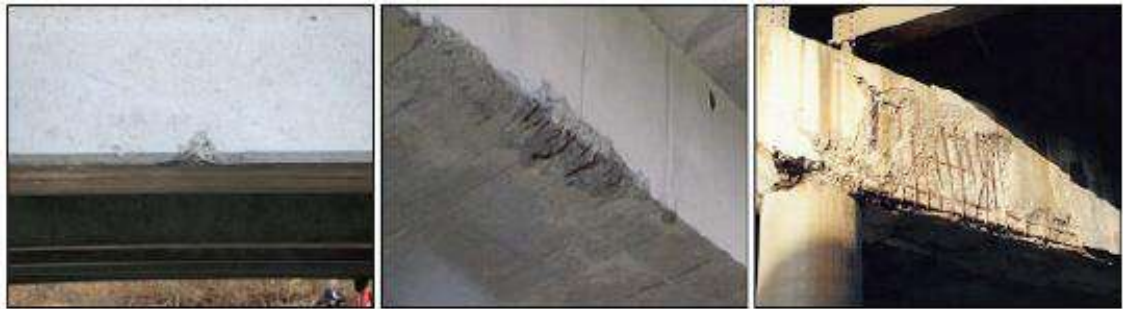
Gambar 2.23 Ilustrasi Kode Kerusakan 201 Cacat pada Beton dari Kiri ke Kanan Kerusakan Berupa Gompal Bertambah Parah dan Volume Semakin Meluas (Wisconsin DOT, 2020)
