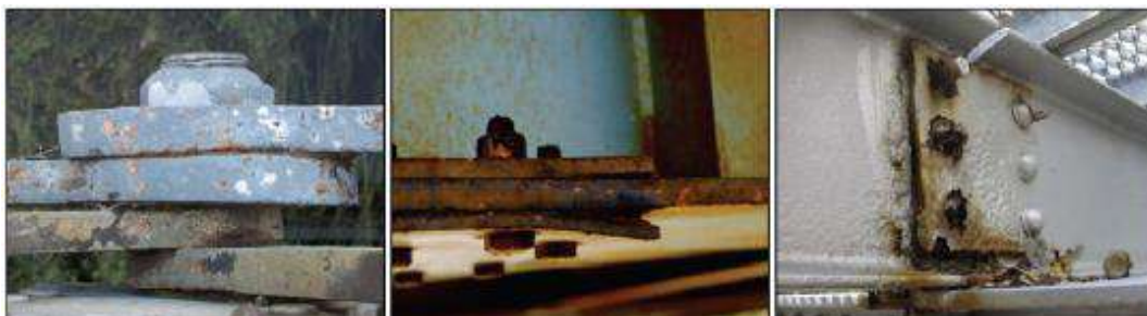
Gambar 2.33 Ilustrasi Kode Kerusakan 308 Sambungan yang Longgar, dari Kiri ke Kanan Kerusakan Bertambah Parah atau Volume Semakin Meluas (Wisconsin DOT, 2020)
