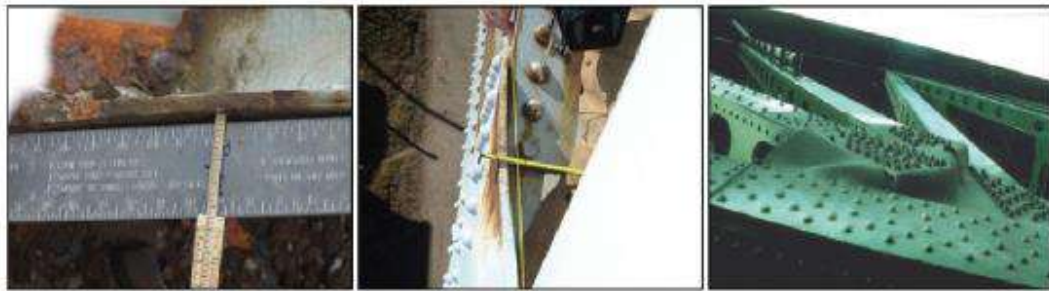
Gambar 2.31 Ilustrasi Kode Kerusakan 303 Perubahan Bentuk pada Komponen, dari Kiri ke Kanan Kerusakan Bertambah Parah atau Volume Semakin Meluas (Wisconsin DOT, 2020)
