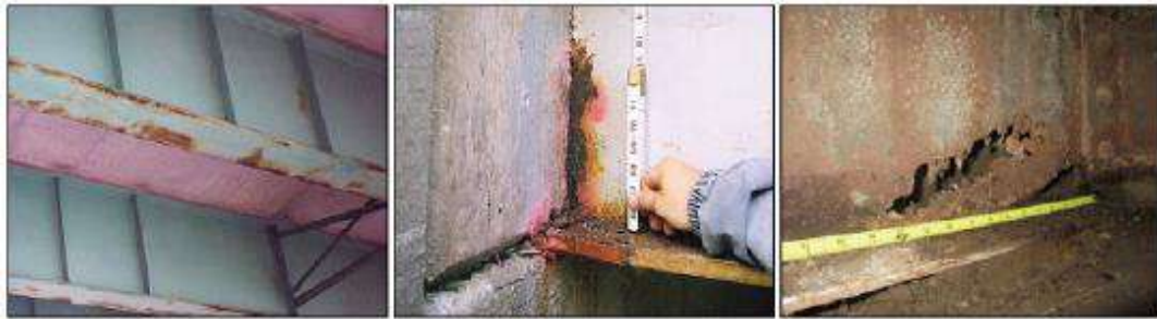
Gambar 2.30 Ilustrasi Kode Kerusakan 302 Karat, dari Kiri ke Kanan Kerusakan Bertambah Parah atau Volume Semakin Meluas (Wisconsin DOT, 2020)
