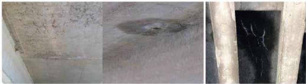
Gambar 2.26 Ilustrasi Kode Kerusakan 204 Kotor, Berlumut, Penuaan atau Pelapukan Beton, Rembesan, dari Kiri ke Kanan Kerusakan Bertambah Parah dan atau Volume Semakin Luas (Wisconsin DOT, 2020)
