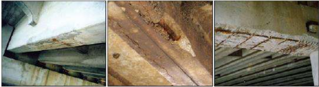
Gambar 2.25 Ilustrasi Kode Kerusakan 203 Karat Baja Tulangan, Kerusakan Berupa Tulangan yang Terekspos dari Kiri ke Kanan Kerusakan Bertambah Parah dan atau volume Semakin Luas (Wisconsin DOT, 2020)
