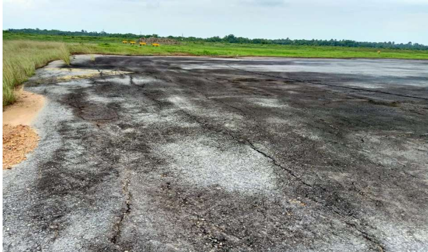
Gambar 1.4 Retakan Memanjang pada Area Stopway
