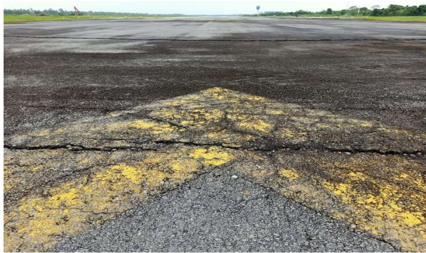
Gambar 1.3 Retakan Melintang pada Area Stopway
