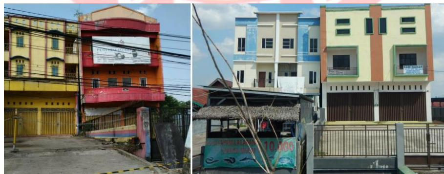
Gambar 1.2 Kerusakan Struktur Bangunan (Gedung Terlihat Miring) yang Dibangun Diatas Tanah Lempung.
