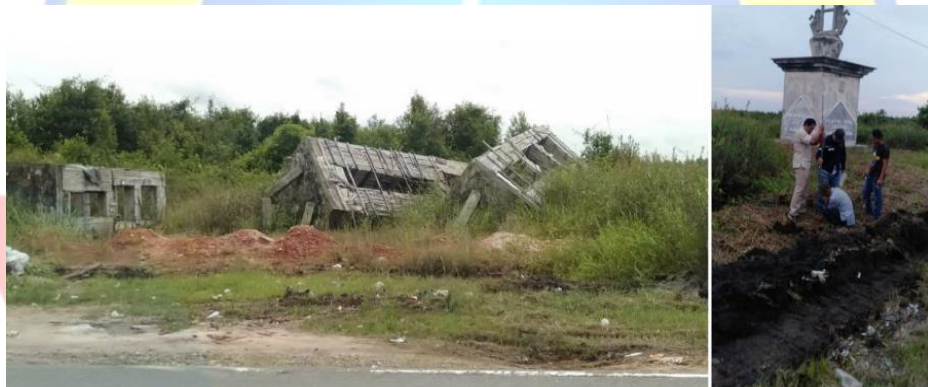
Gambar 1.1 Kegagalan Struktur pada Bangunan Tugu Perbatasan yang Dibangun Diatas Tanah Lempung.
