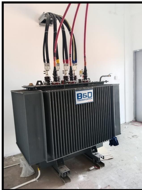
Gambar 4.5 Transformator Step Down Rumah Sakit Hermina Pasuruan
