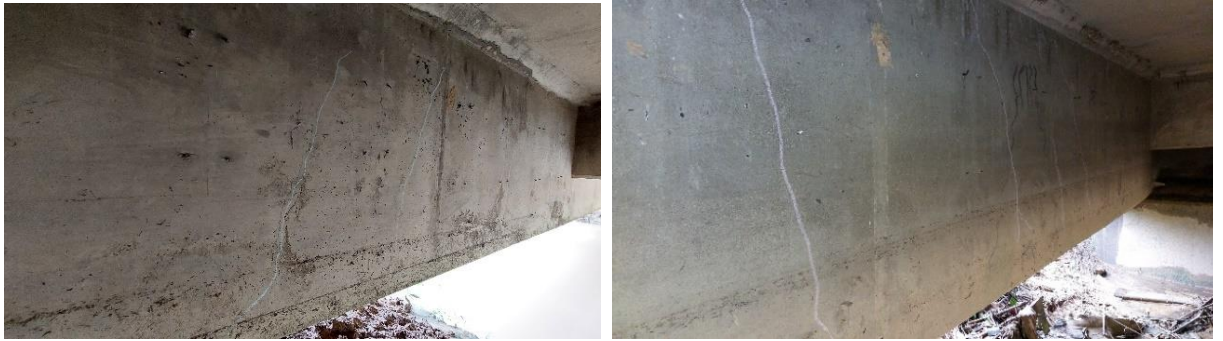
Gambar 1. 1 Retak Geser pada Balok Jembatan
