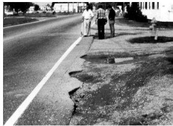
Gambar 2. 10 Retak Samping Jalan ( Edge Cracking )
