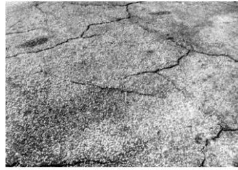
Gambar 2. 6 Retak Blok ( Block Cracking )
