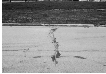
Gambar 2. 13 Retak Memanjang atau Retak Melintang (Longitudinal and Transverse Cracking)
