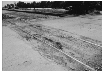
Gambar 2. 17 Rusak pada Perlintasan Kereta Api ( Railroad Crossing )
