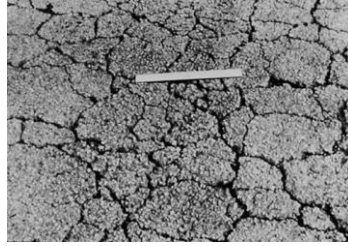
Gambar 2. 4 Retak Kulit Buaya ( Alligator Cracking )
