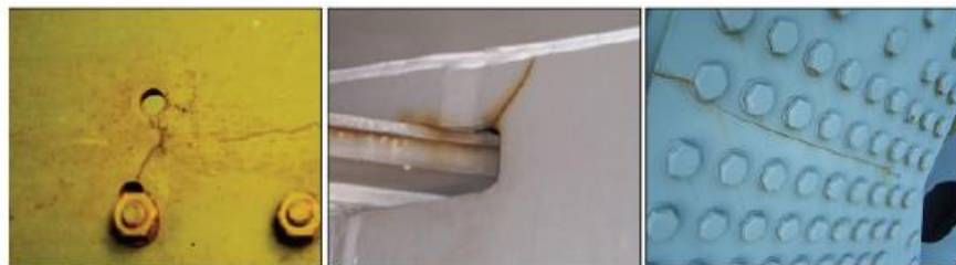
Gambar 2.28 Ilustrasi Kode Kerusakan 304 Retak (Elemen Baja dan Las), dari Kiri ke Kanan Kerusakan Bertambah Parah atau Volume Semakin Meluas (Wisconsin DOT, 2020)
