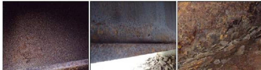
Gambar 2.24 Ilustrasi Kode Kerusakan 301 Penurunan Mutu atau Kinerja Proteksi Korosi (Lapisan Pelindung/Cat), dari Kiri ke Kanan Kerusakan Berupa Degradasi Film Oksida dan Tekstur Bertambah Parah atau Volume Semakin Meluas (Wisconsin DOT, 2020)
