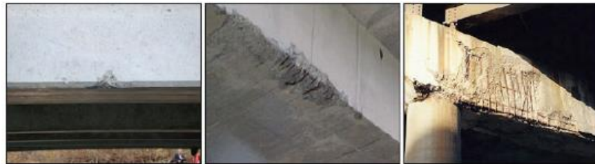
Gambar 2.19 Ilustrasi Kode Kerusakan 201 Cacat pada Beton dari Kiri ke Kanan Kerusakan Berupa Gompal Bertambah Parah dan Volume Semakin Meluas (Wisconsin DOT, 2020)
