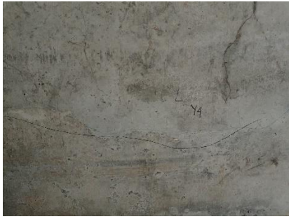
Plat lantai retak (elemen beton)
