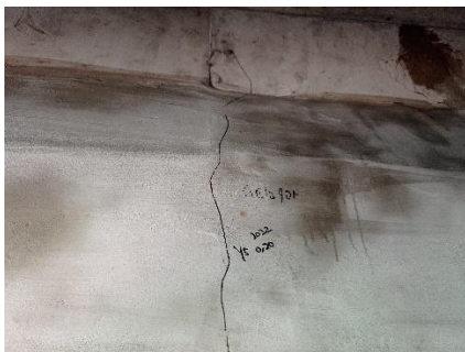
Gelagar retak (elemen beton)
