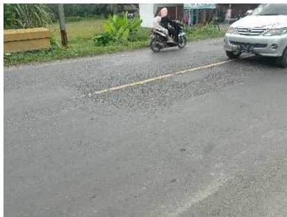
Retak pada lapisan permukaan.
