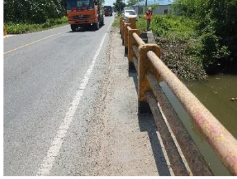
Pipa cucuran atau drainase yang tersumbat.
