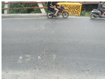
Penurunan tanah timbunan
