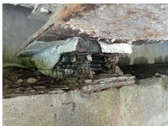
Landasan baja rusak/hilang
