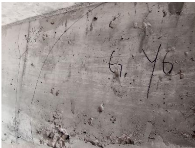
Gelagar retak (elemen beton)
