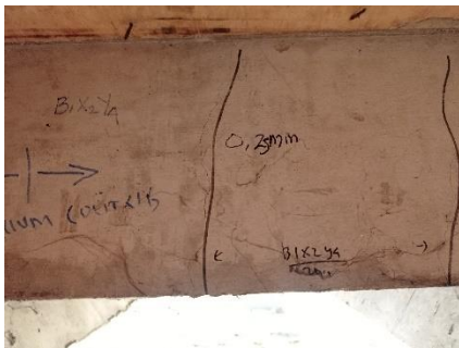
Diafragma retak (elemen beton)
