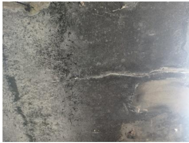
Plat lantai retak (elemen beton)
