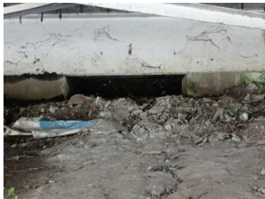
Batang penahan gempa rusak/hilang
