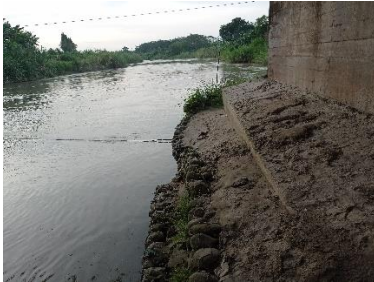
Talud (pengikisan disekitar jembatan)
