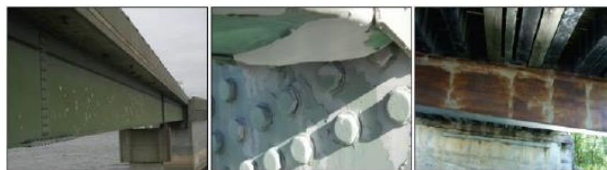
Gambar 2.25 Ilustrasi Kode Kerusakan 301 Penurunan Mutu atau Kinerja Proteksi Korosi (Lapisan Pelindung/Cat), dari Kiri ke Kanan Kerusakan Kehilangan Keefektifan Pengecatan Bertambah Parah atau Volume Semakin Meluas (Wisconsin DOT, 2020)
