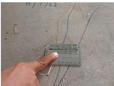
Pelat lantai retak (elemen beton)
