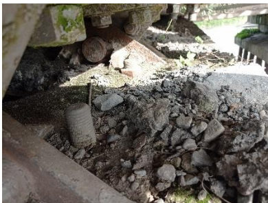
Landasan baja rusak/hilang
