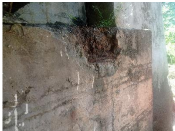
Kepala jembatan rontok (elemen beton)
