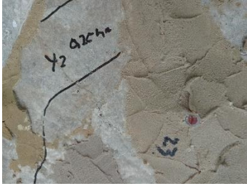
Plat lantai retak (elemen beton)
