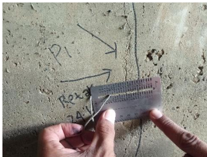
Retak (elemen beton)
