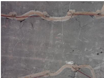
Plat lantai retak (elemen beton)
