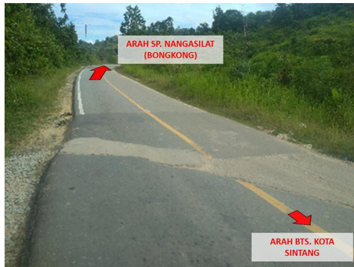
Gambar 4. 3 Longsor Ruas Jalan Bts. Kota Sintang - Sp. Nangasilat (Bongkong) KM 448+650
