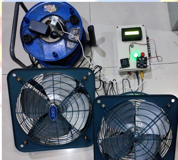
Gambar 17 - Modul Sistem Deteksi Dini Kebocoran Gas Amoniak Berbasis IoT
