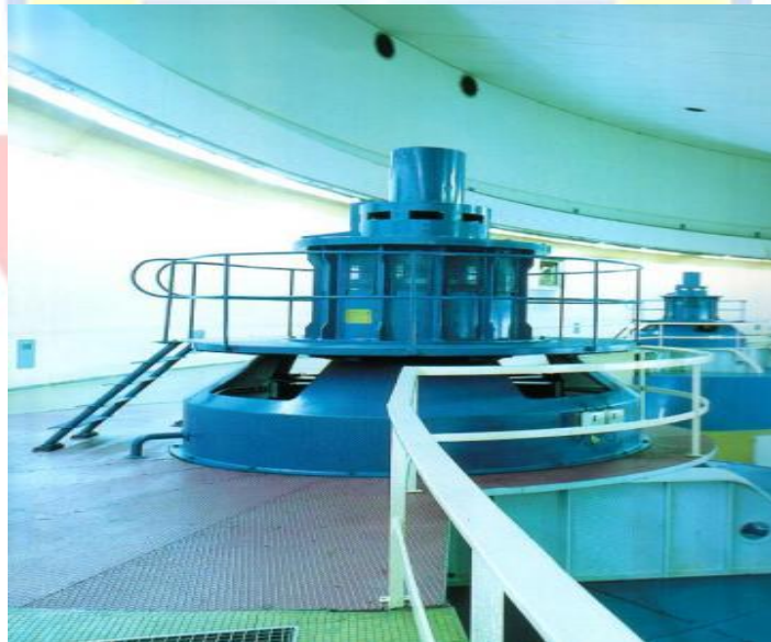
Gambar 3. 11 Generator (Doc. Pribadi)
