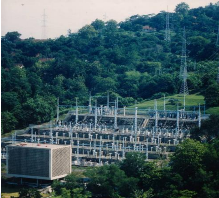
Gambar 3. 17 Switchyard (Doc. PJT II).
