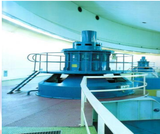
Gambar 3. 16 Generator (Doc. Pribadi).
